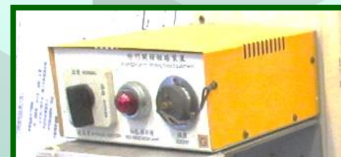
升降機機房內的層站門聯鎖旁通控制裝置
