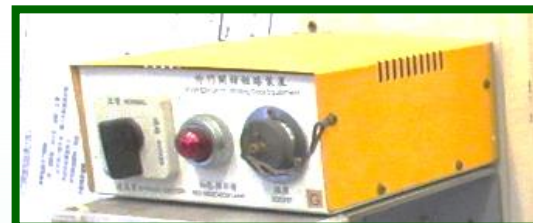
升降机机房内的层站门联锁旁通控制装置
